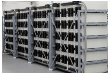
電力貯蔵システム
