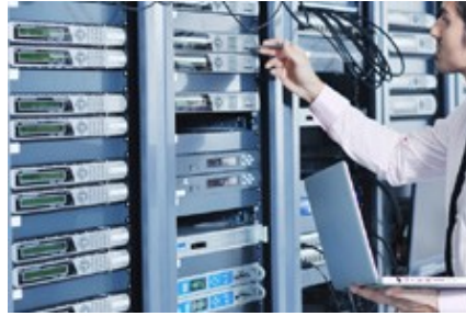
サーバー電源
