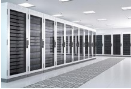
データセンター
